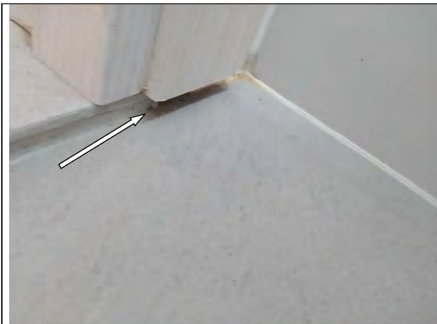
Фото №64. Коротко подрезан наличник деревянного дверного блока в санузле.
