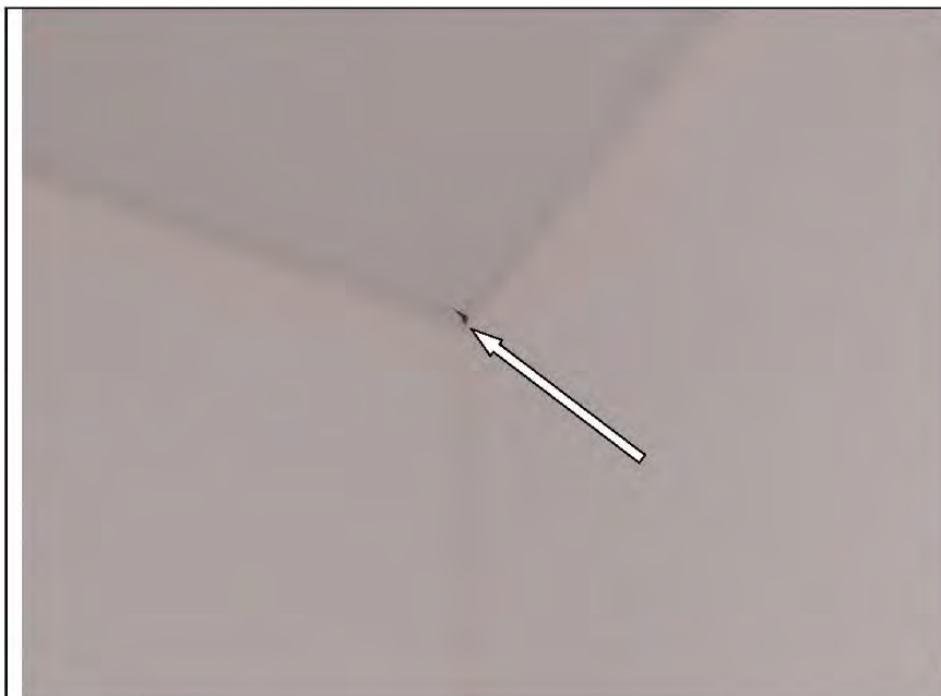
Фото №88. Дефект монтажа декоративного молдинга крепления натяжного потолка в прихожей (щели в угловых соединениях)
