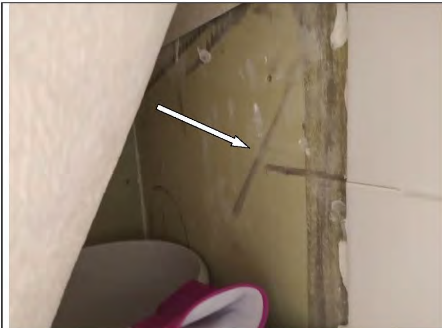
Фото №91. Частично отсутствует настенная керамическая плитка за ванной.
