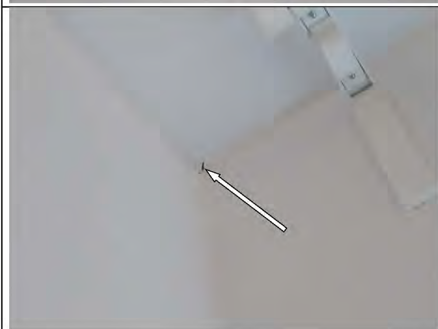
Фото №87. Дефект монтажа декоративного молдинга крепления натяжного потолка в спальне (щели в угловых соединениях)
