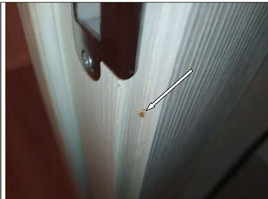
Фото №67. Коробка деревянного дверного блока в спальне имеет дефекты (скол).
