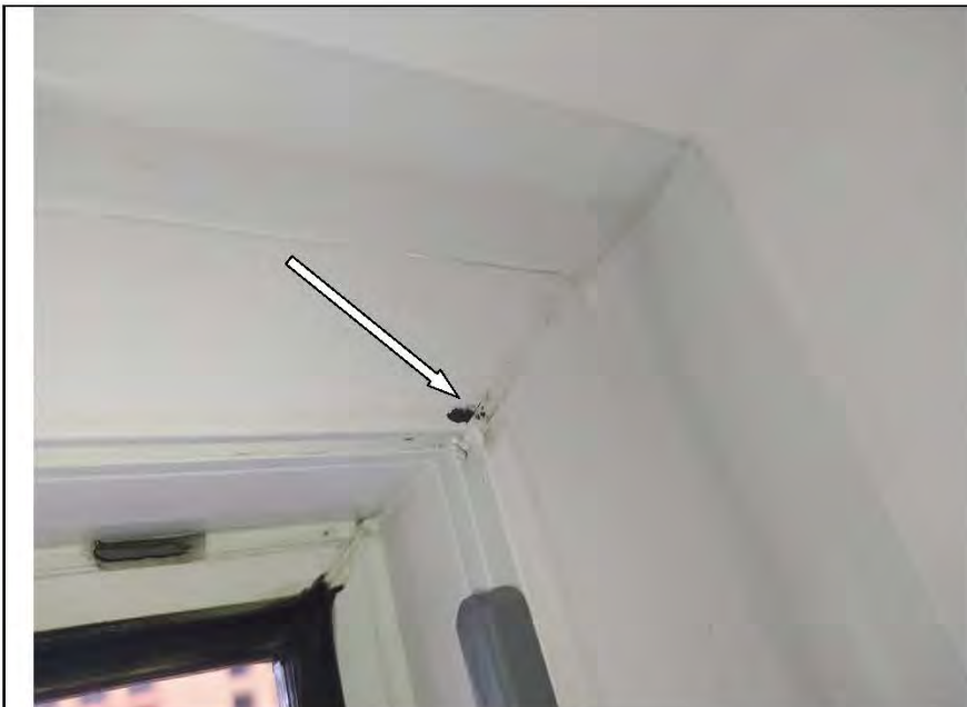
Фото №31. Профиль ПВХ оконного блока №5 в кухне имеет дефекты (скол).
