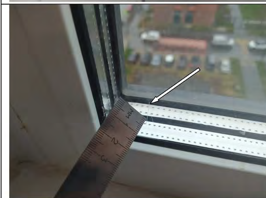
Фото №33. На стеклопакете оконного блока №1 ПВХ в гостиной имеется дефект (царапина).
