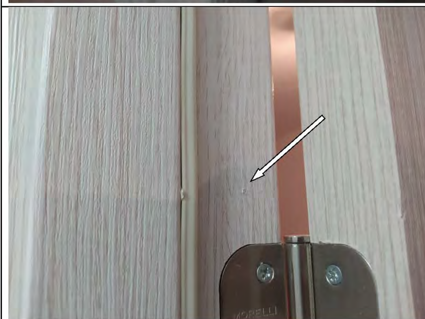
Фото №69. Коробка деревянного дверного блока в санузле имеет дефекты (царапина).
