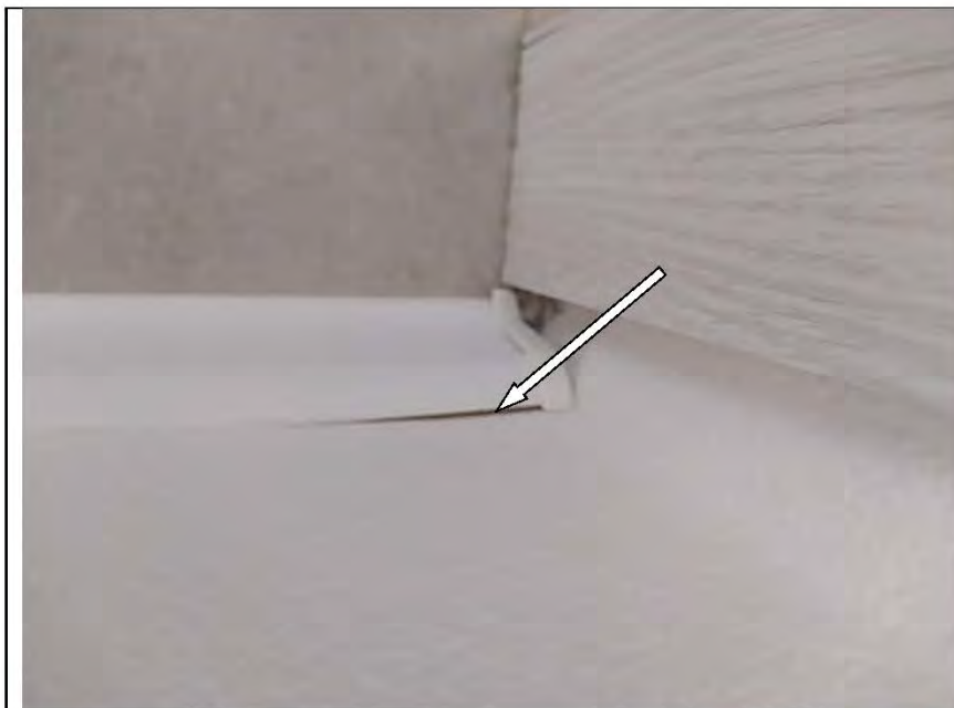
Фото №73. Напольный плинтус ПВХ в кухне неплотно прилегает к стене (отходит), образуется зазор.
