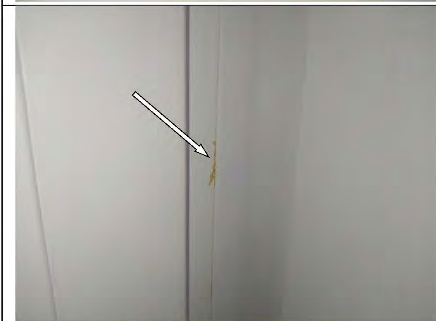
Фото №26. Профиль ПВХ оконного блока №1 в гостиной имеет дефекты (загрязнение монтажной пеной).
