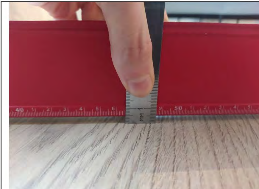
Фото №13. Измерения уровня напольного покрытия в гостиной.
