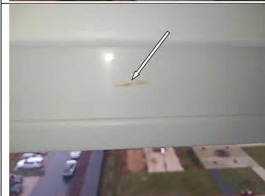
Фото №29. Профиль ПВХ оконного блока №3 в спальне имеет дефекты (загрязнение монтажной пеной).
