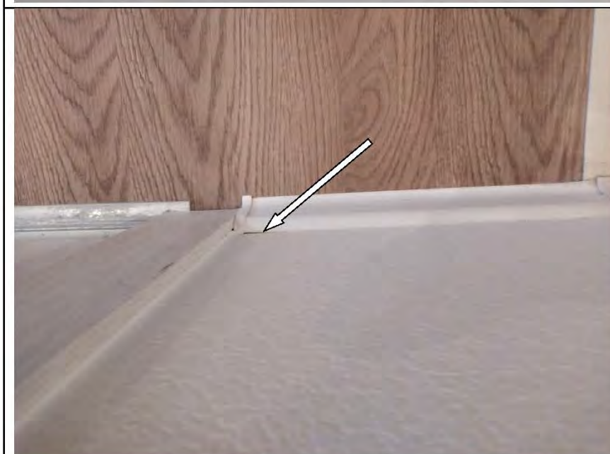
Фото №74. Напольный плинтус ПВХ в прихожей неплотно прилегает к стене (отходит), образуется зазор.
