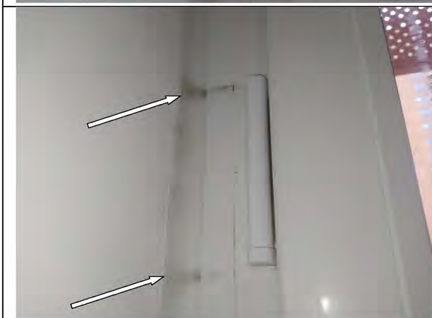
Фото №44. Следы скопления пыли, свидетельствующие об инфильтрации воздуха через петли оконного блока №3 в спальне.
