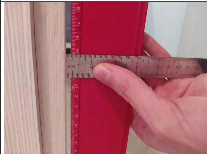
Фото №56. Отклонение коробки дверного блока в спальне.
