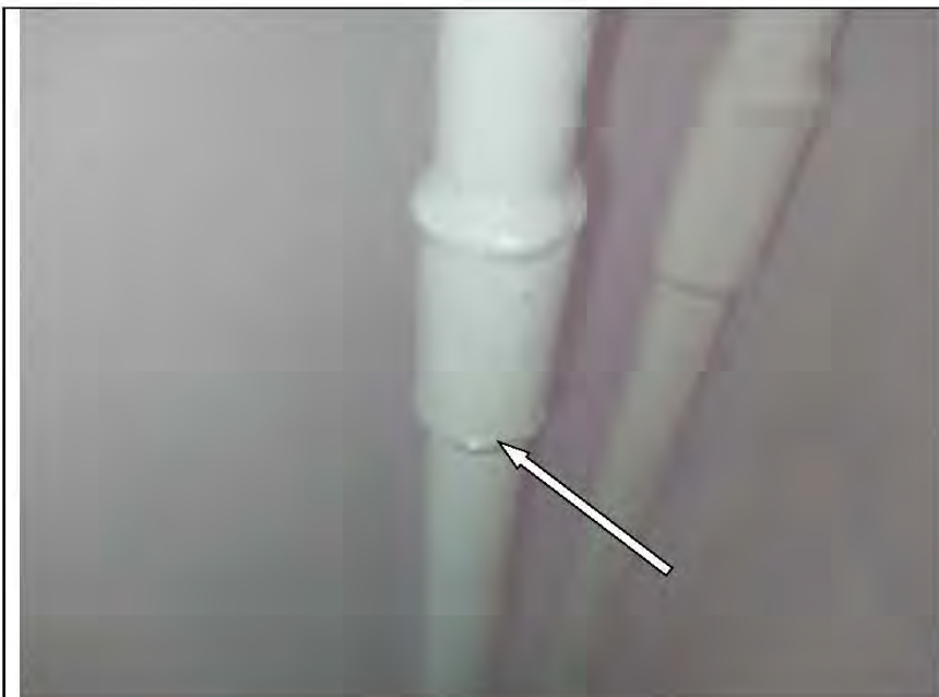
Фото №85. Окрашивание труб отопления в кухне выполнено с дефектами (подтеки).
