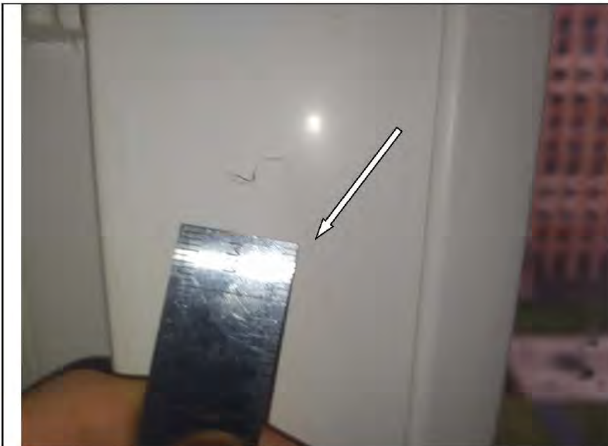
Фото №28. Профиль ПВХ оконного блока №3 в спальне имеет дефекты (царапина).
