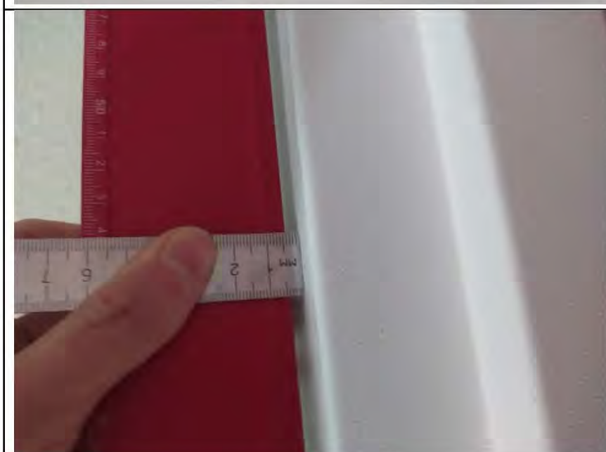
Фото №90. Отклонение коробки входного дверного блока
