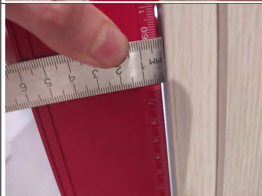
Фото №57. Отклонение коробки дверного блока в кухне.
