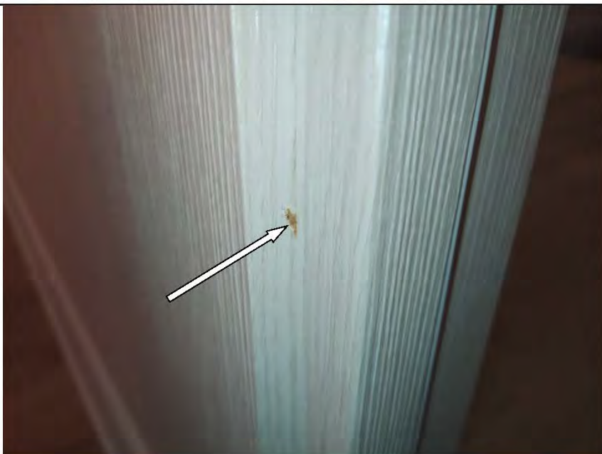
Фото №60. Наличник деревянного дверного блока в спальне имеет дефекты (скол).
