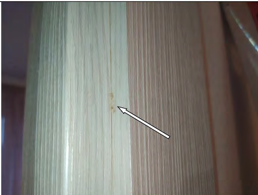
Фото №59. Наличник деревянного дверного блока в гостиной имеет дефекты (скол).
