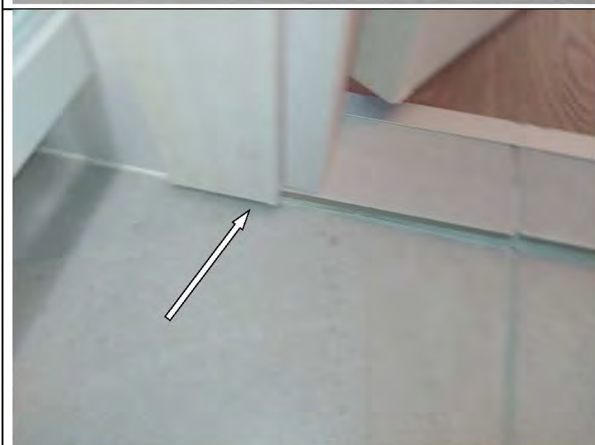
Фото №65. Коротко подрезан наличник деревянного дверного блока в ванной комнате.
