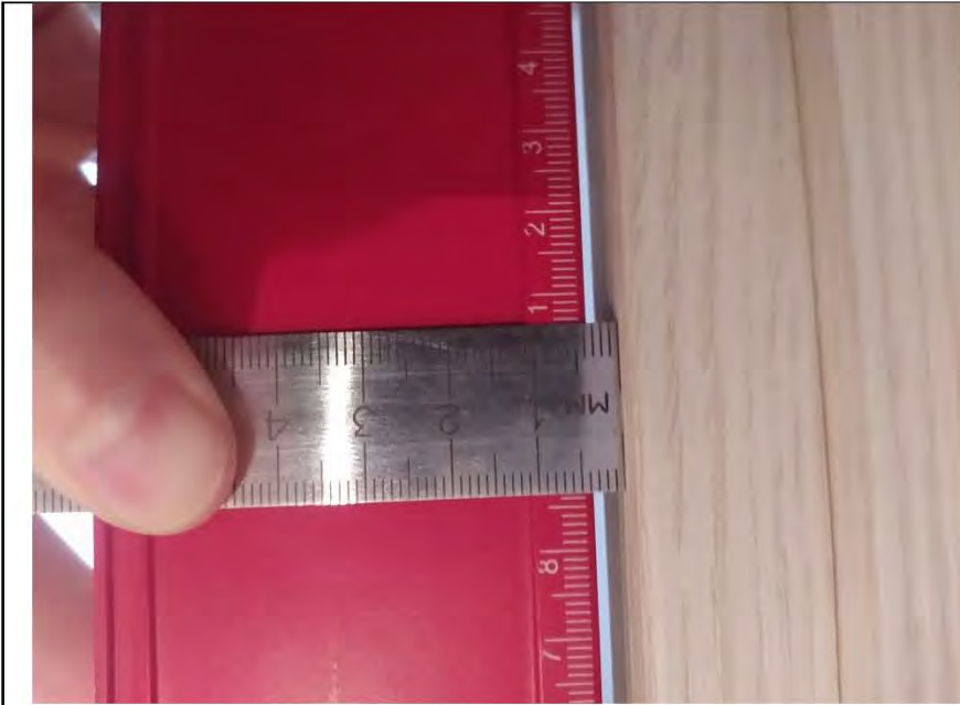
Фото №55. Отклонение коробки дверного блока в гостиной.
