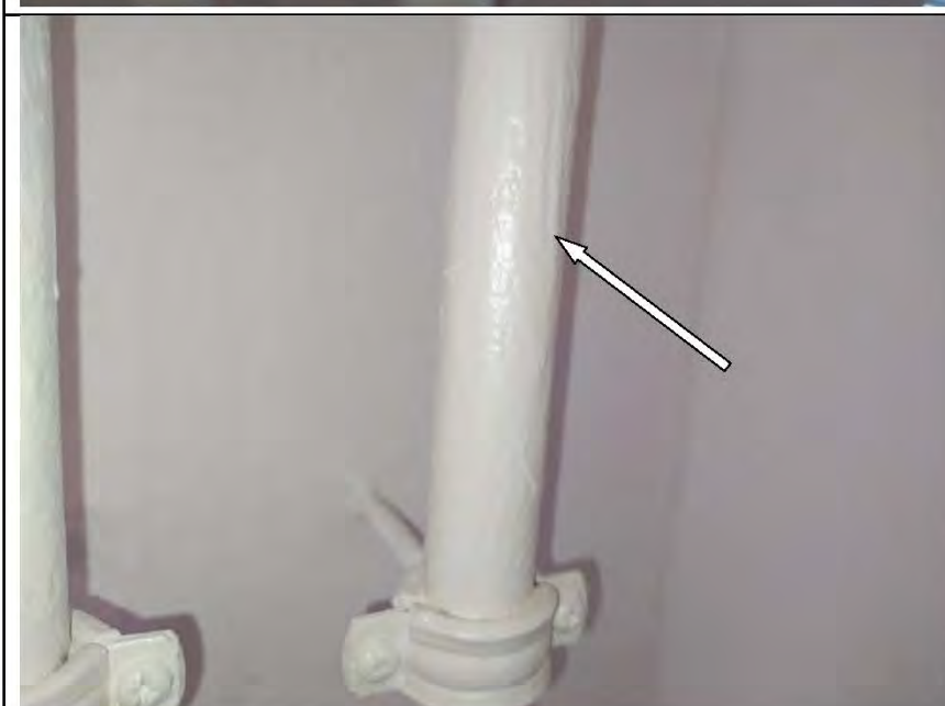
Фото №84. Окрашивание труб отопления в спальне выполнено с дефектами (подтеки).
