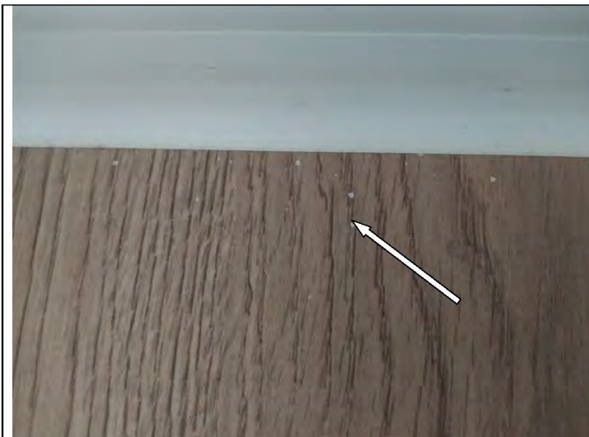
Фото №82. Загрязнения на поверхности ламината в спальне.
