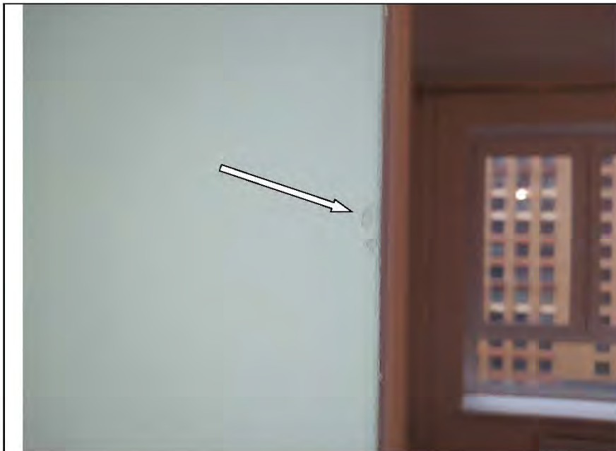
Фото №19. Отлупы на окрашенной поверхности откосов оконного блока №1 в гостиной.
