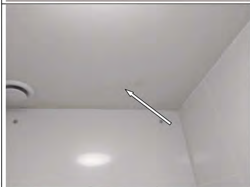
Фото №89. Следы заливки навесной потолочной ЛДСП панели в санузле.
