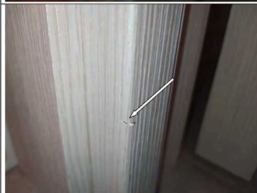
Фото №68. Коробка деревянного дверного блока в кухне имеет дефекты (скол).
