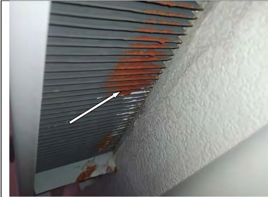
Фото №52. Отопительный прибор №2 имеет дефект в гостиной (загрязнение малярными составами).
