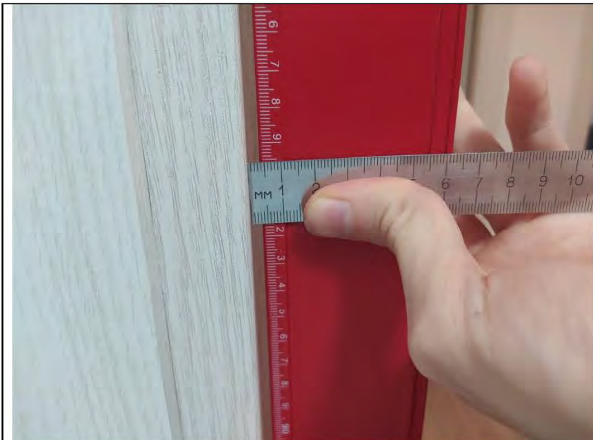
Фото №58. Отклонение коробки дверного блока в санузле.
