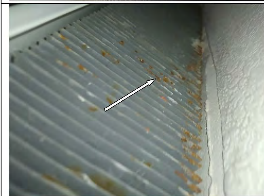
Фото №54. Отопительный прибор имеет дефект в кухне (поверхностная коррозия).
