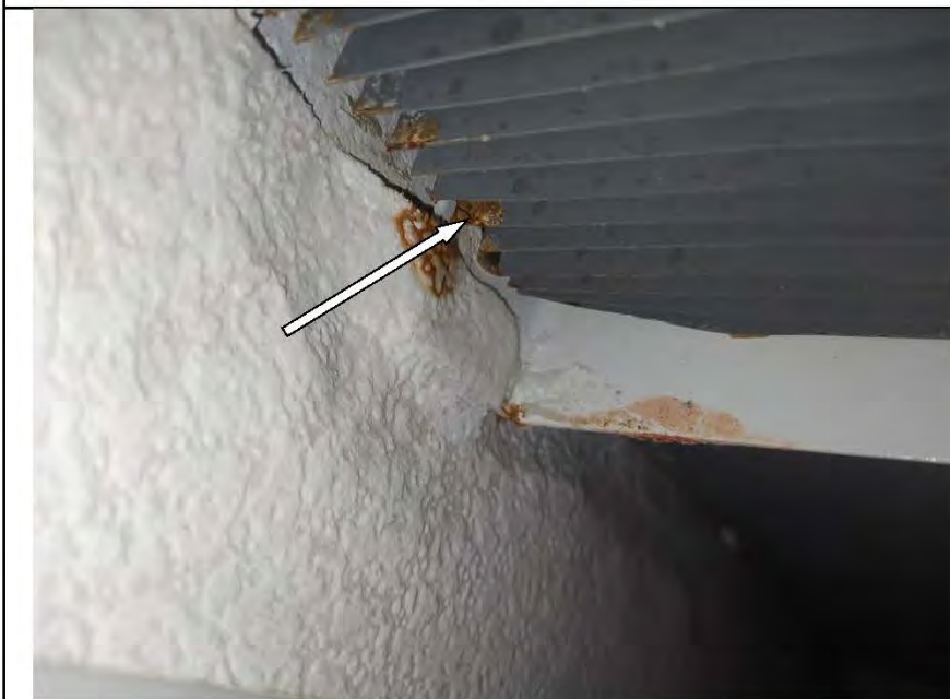
Фото №53. Отопительный прибор имеет дефект в спальне (поверхностная коррозия).
